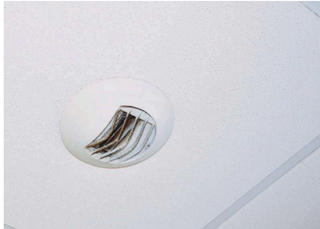
Bouche d'extraction d'air encrassée
