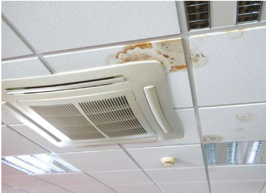
Développement de moisissures
